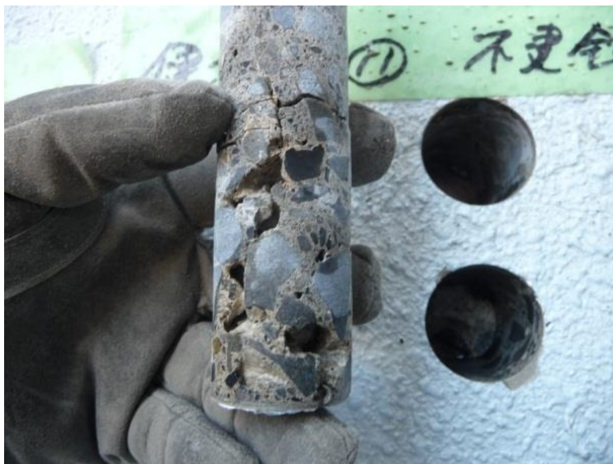
初期欠陥（締固め不良）
