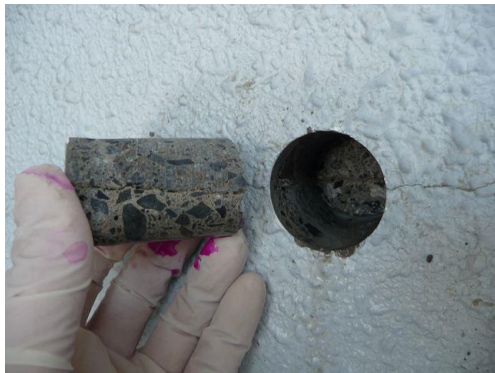
コールドジョイントによるひび割れ 下部には、骨材あるのに対し上部には骨材が見当たらない（打継ぎ）
